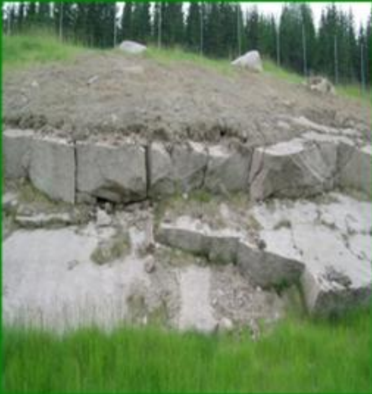
Fractura por Descompresión del Granito
